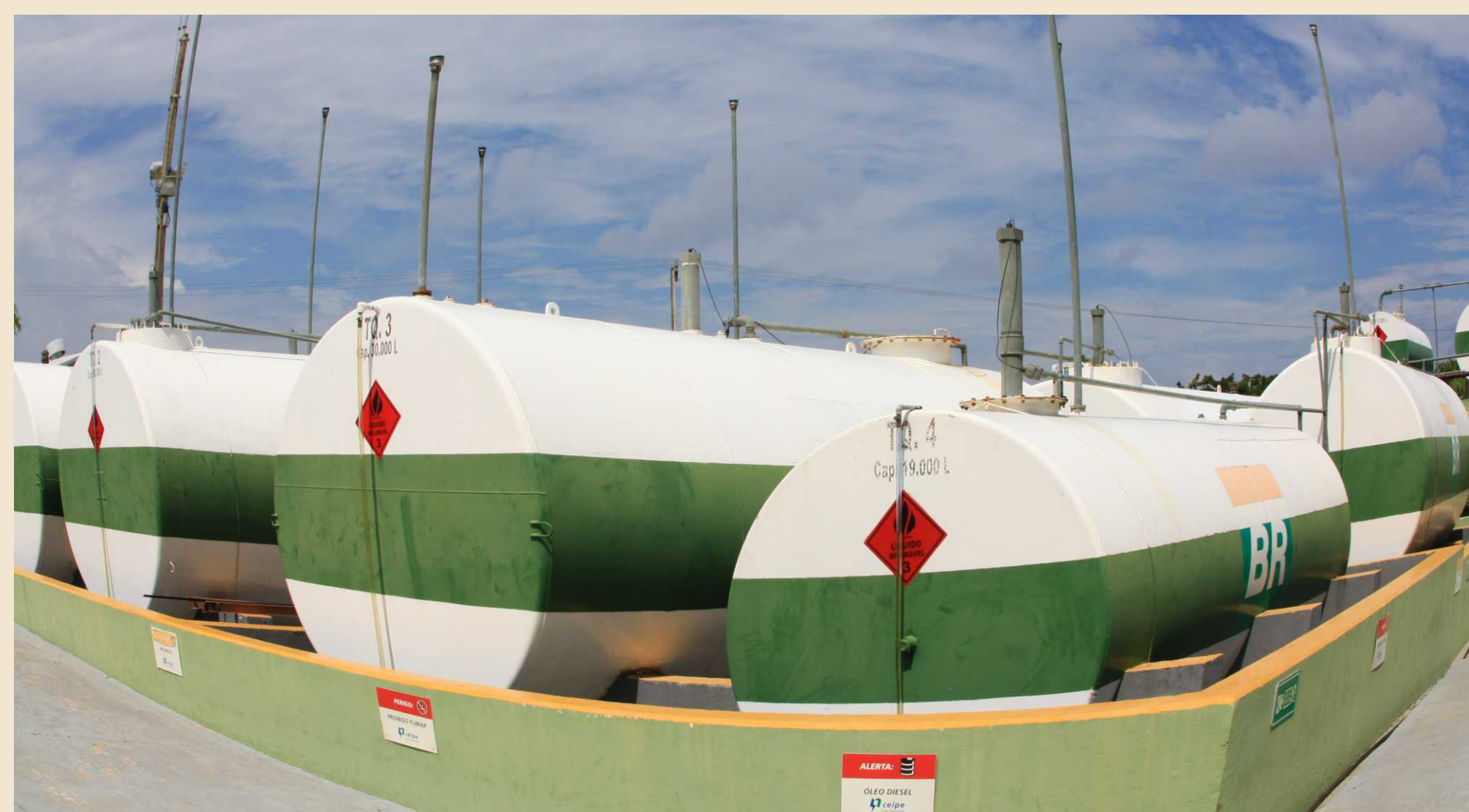
Usina Termoeletrica Tubarão - produz energia gerada a 98% de óleo diesel e 2% de biodiesel B2, operando com capacidade de 4MW.
