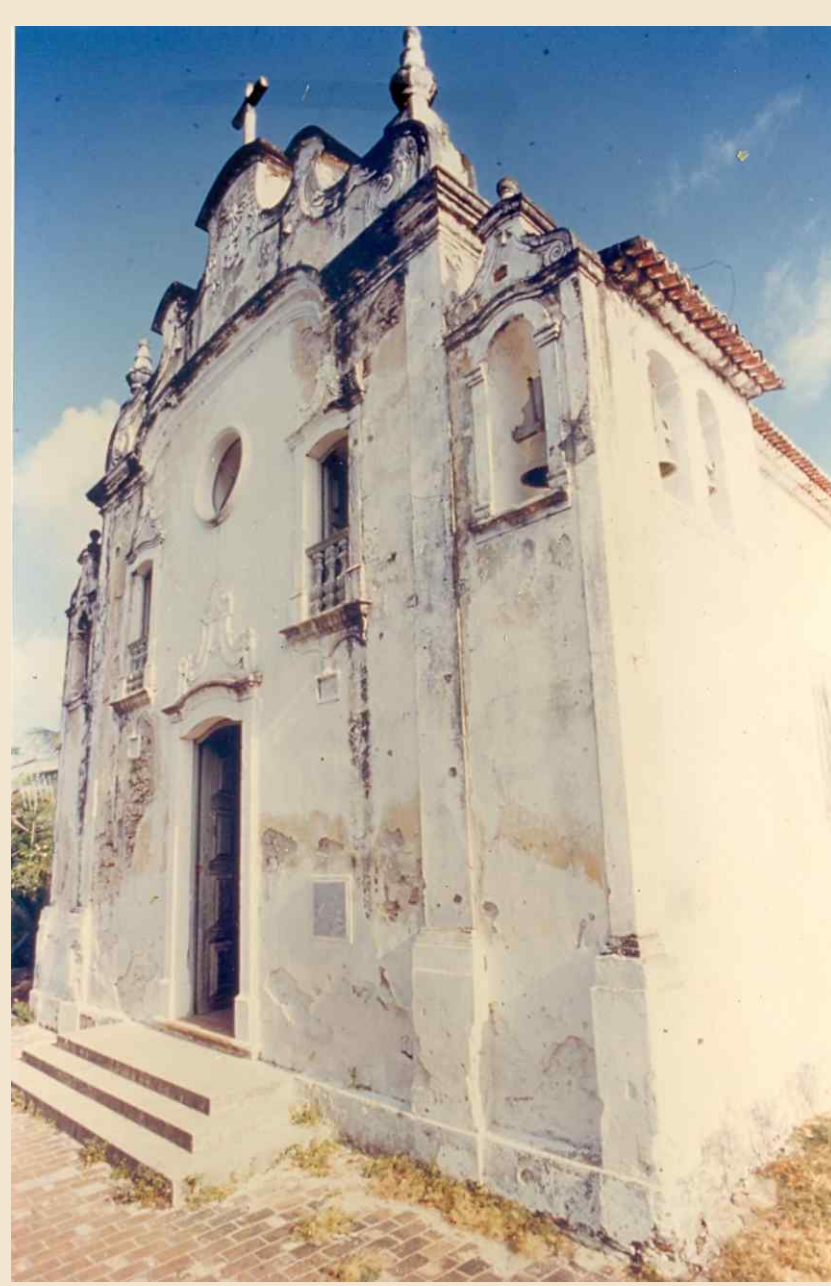
Igreja dos Remédios - 1986 - bastante danificada.
